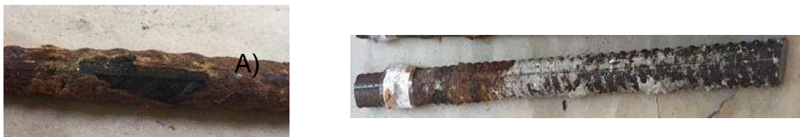
Figura 3. Varillas expuestas A) VOA en Sedimento, B) VOI en Sedimento.
